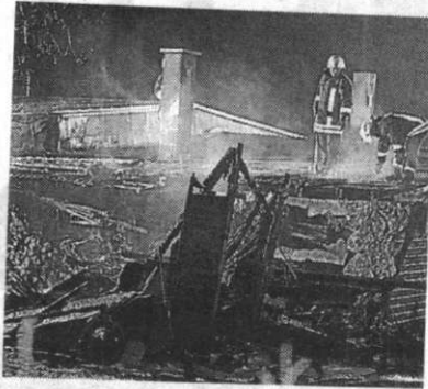
Das Vereinsheim wurde stark beschädigt.
